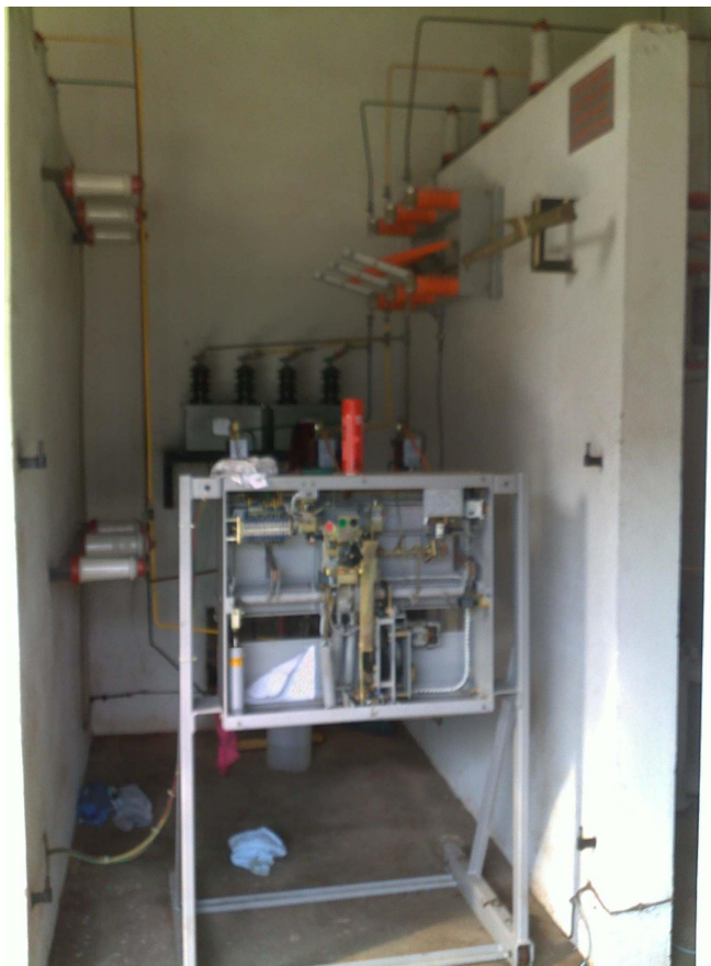
Cela do disjuntor principal atual, em ocasião de manutenção, com a grade removida.
