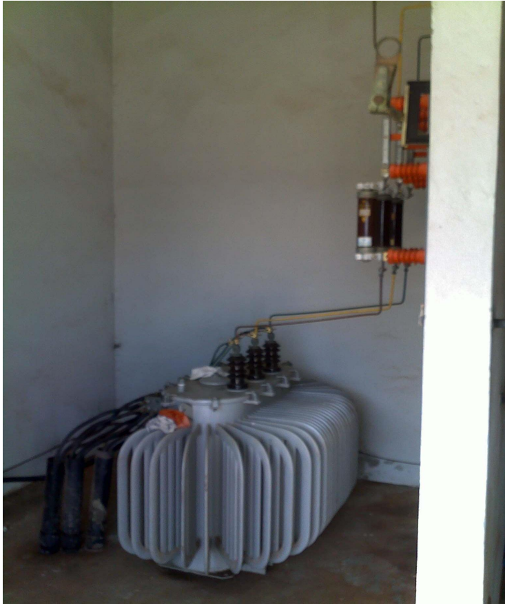
Cela do transformador principal atual, em ocasião de manutenção, com a grade removida.
