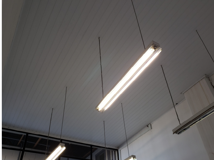
Foto 06- SALA DE ESPERA: forro de pvc a ser removido
