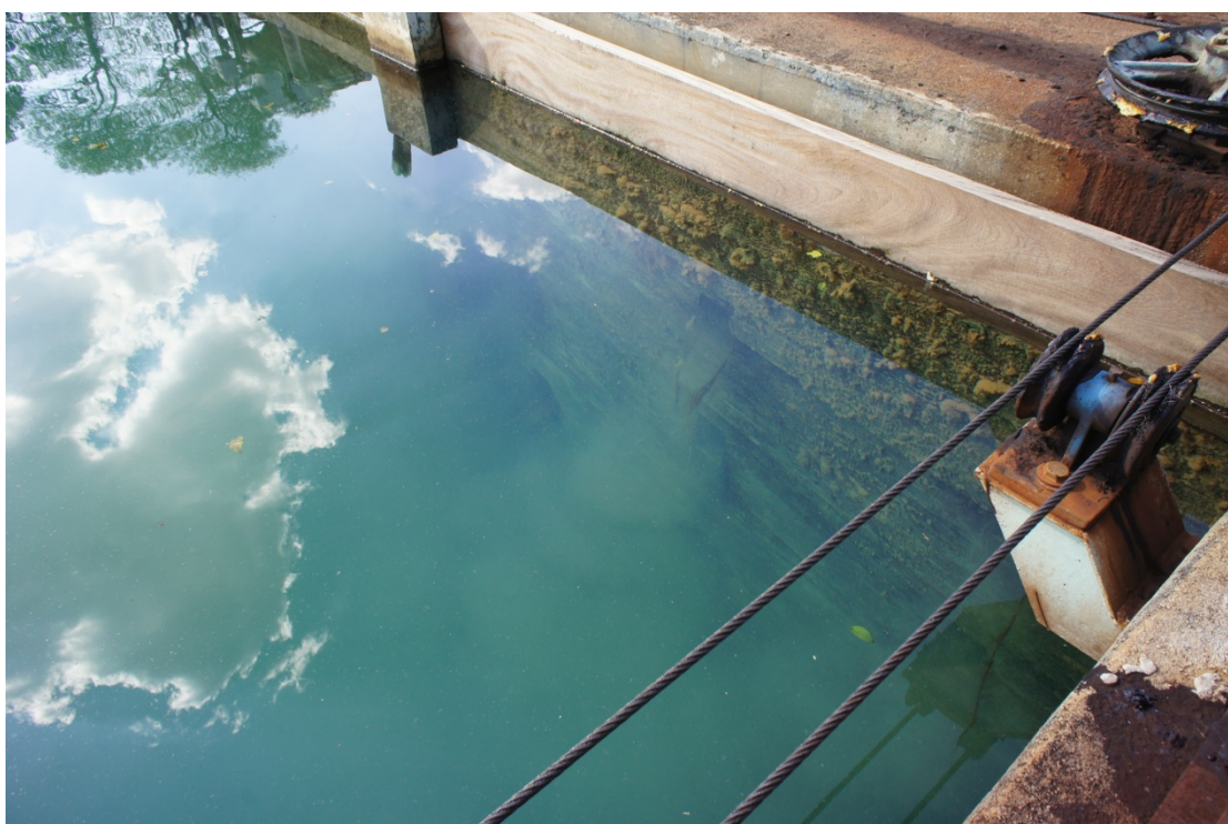
Figura 14 – Ruptura de flocos formados durante o processo de floculação quando da passagem por estruturas de distribuição compostas por orifícios ou bocais – ETA 2 SANASA
