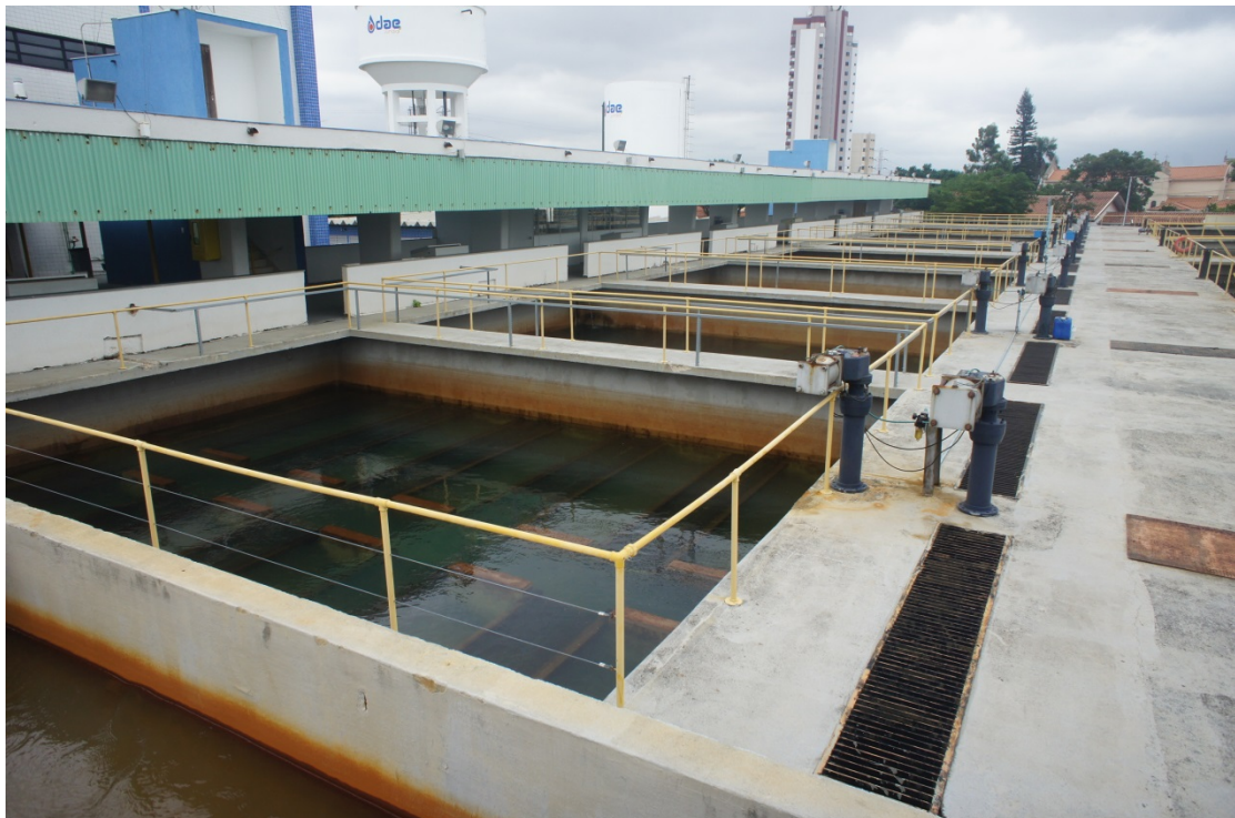
Figura 10 – Vista geral das unidades de filtração implantadas na ETA Anhangabaú – Filtros rápidos por gravidade
