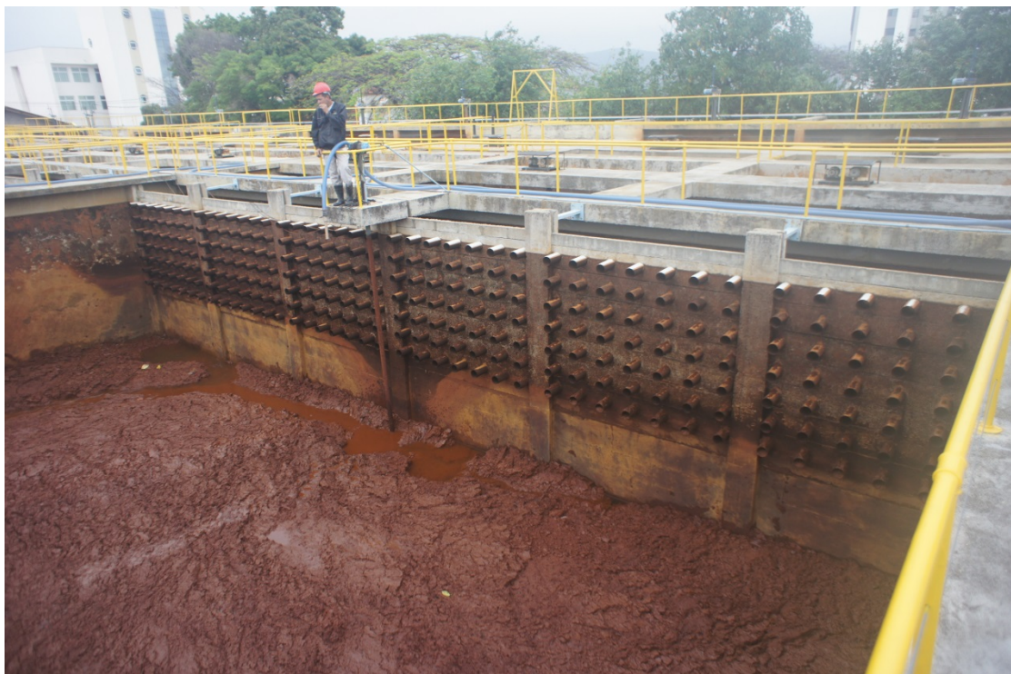
Figura 13 – Estruturas de saída do canal de água floculada e passagem para os decantadores
