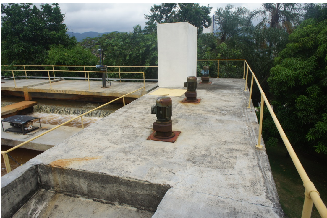
Figura 5 – Vista geral da unidade de mistura rápida concebida para a ETA Anhangabaú – Projeto SEREC
