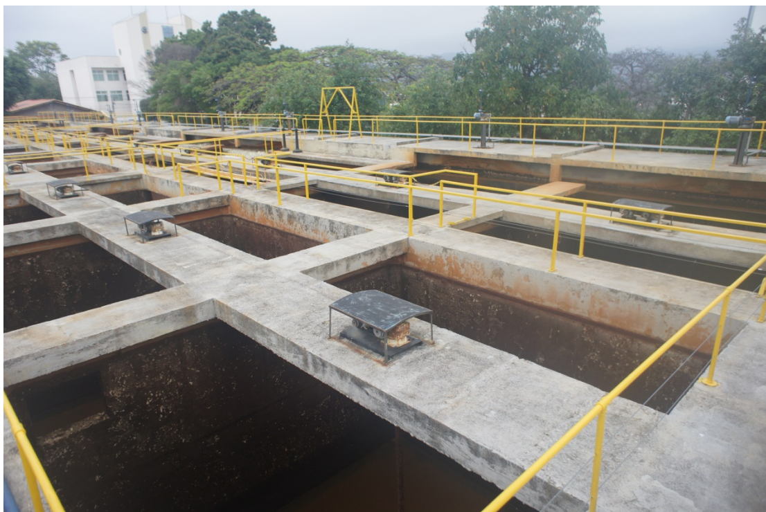
Figura 8 – Vista geral de uma unidade de floculação típica em operação na ETA Anhangabaú
