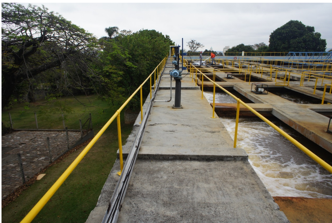
Figura 6 – Vista geral do canal de água coagulada e sua distribuição entre as unidades de floculação e respectivos módulos de tratamento
