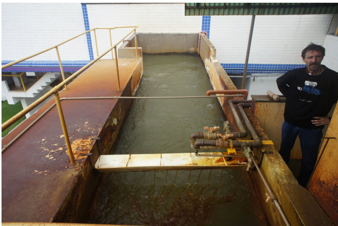
Figura 4 – Vista geral do canal de chegada de água bruta na ETA Anhangabaú
