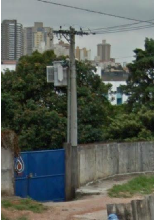
Vista do transformador
