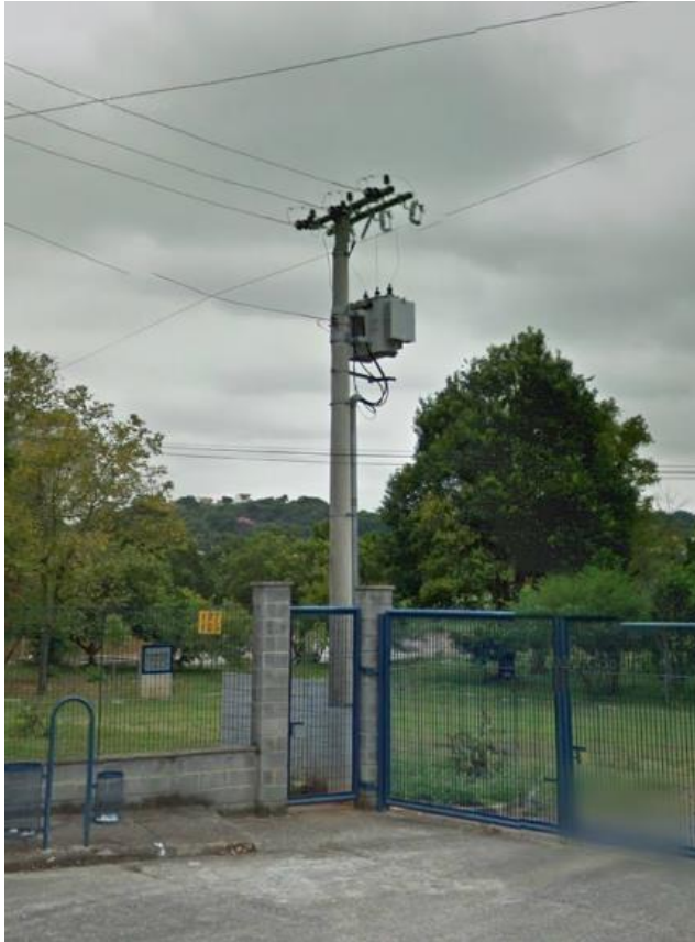
Vista do transformador
