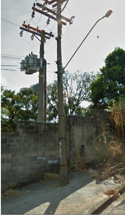
Vista do transformador
