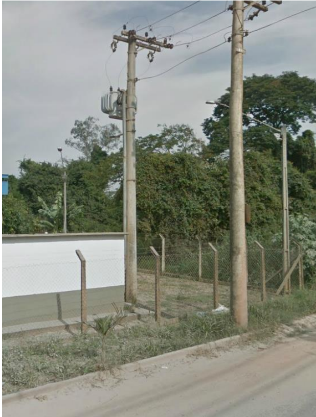
Vista do transformador
