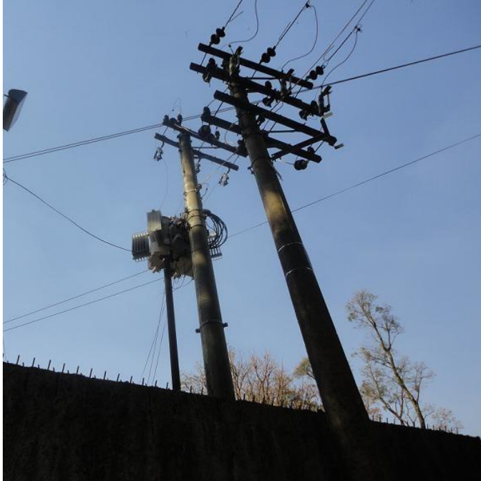
Vista do transformador
