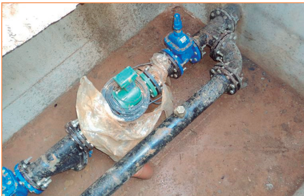
Figura 8 - Exemplo de Instalação de Macromedidor
