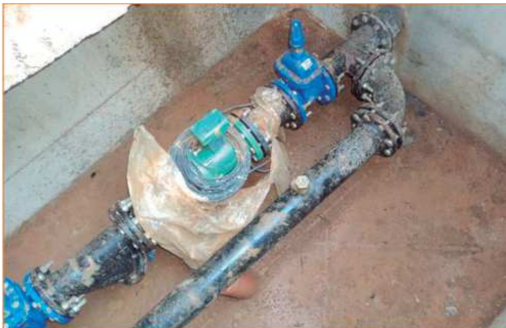
Figura 18 - Exemplo de instalação de macromedidor
