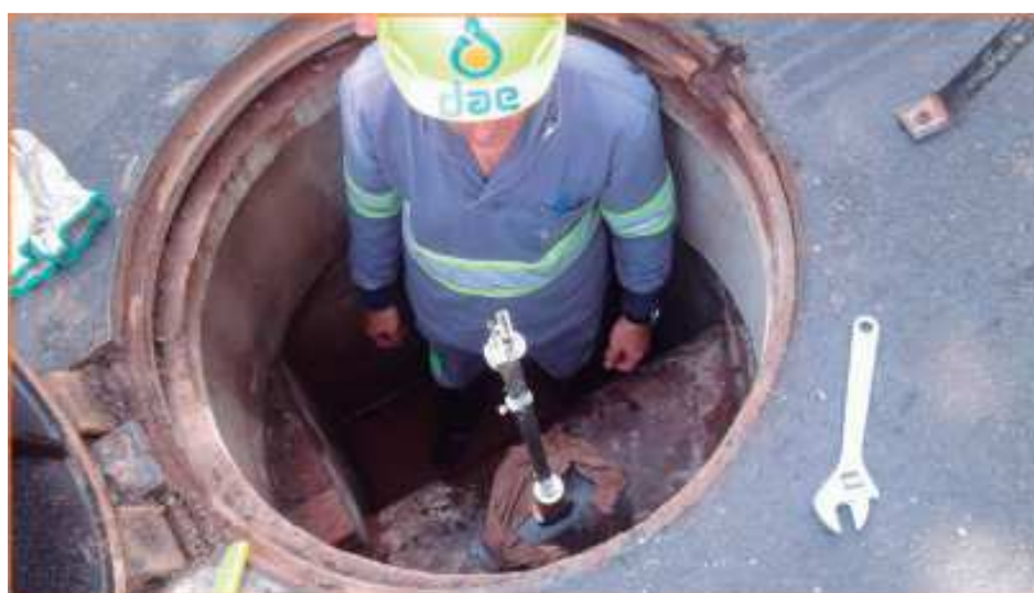
Figura 20 - Estação pitométrica em adutora
