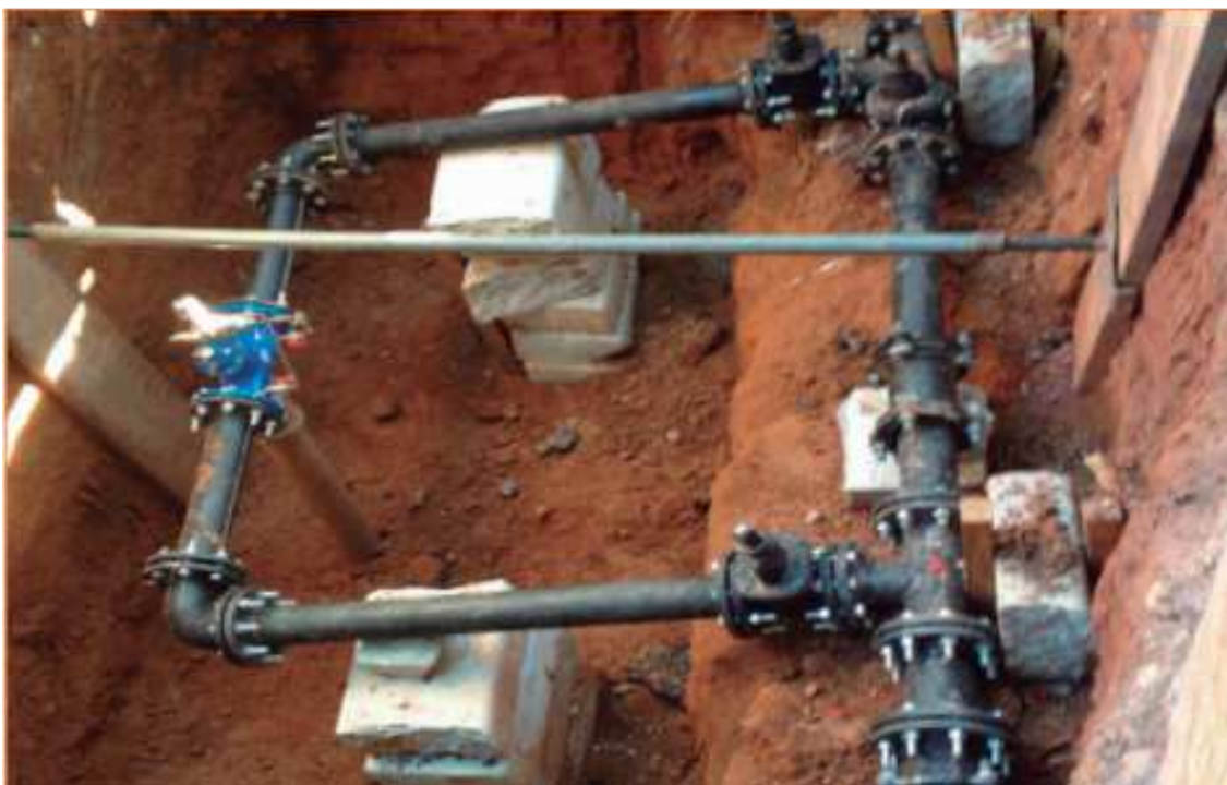
Figura 11 - Exemplo de instalação de VRP
