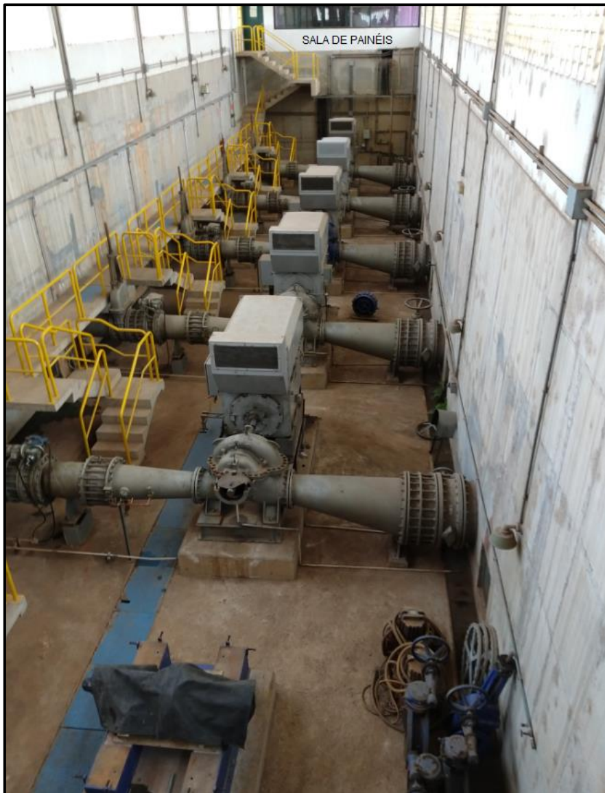
3.4.10 Foto - Área das bombas de recalque
