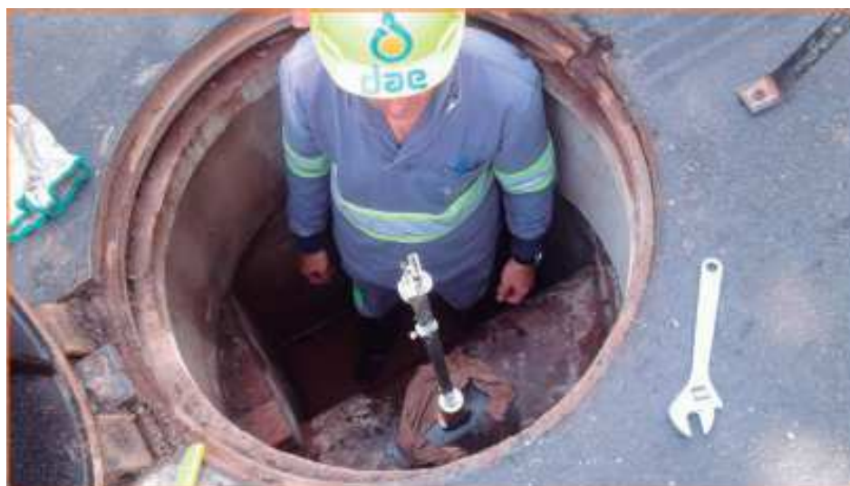
Figura 20 - Estação pitométrica em adutora
