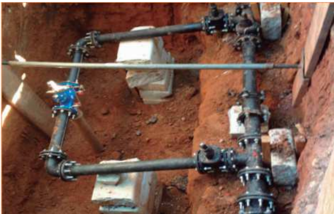
Figura 11 - Exemplo de instalação de VRP
