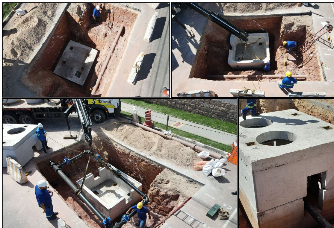
Figura 11 - Exemplo de instalação de VRP
