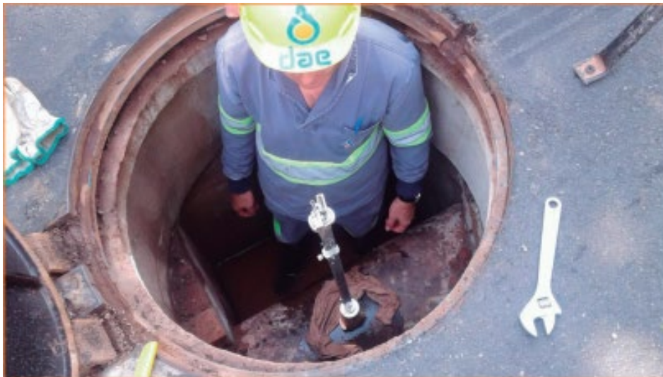
Figura 20 - Estação pitométrica em adutora
