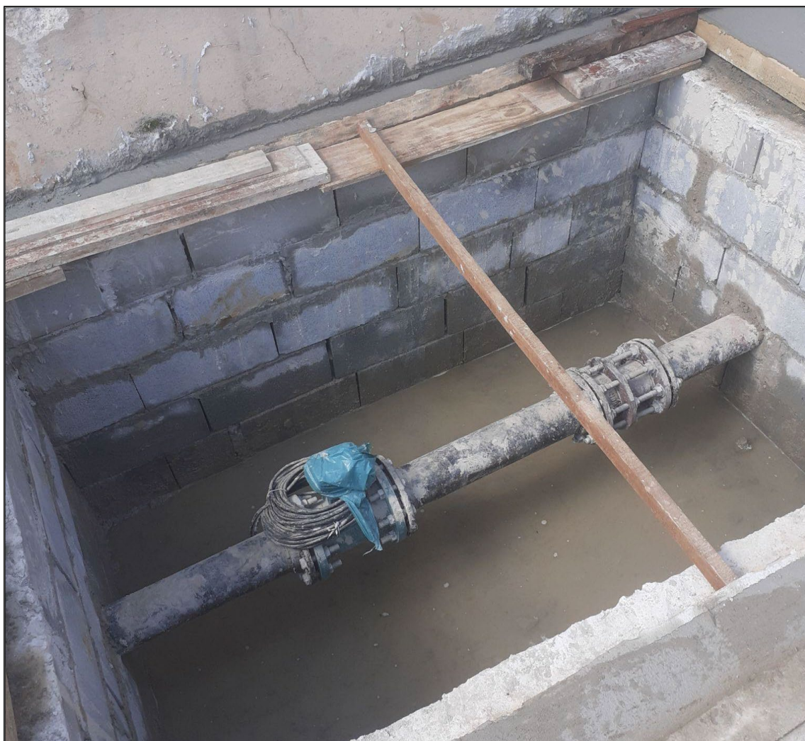
Figura 18 - Exemplo de instalação de macromedidor
