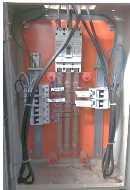
Figura 4: QD-10 - Vista interna.
