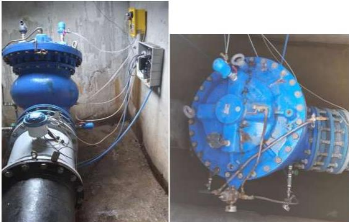
Figura 1 – Modelo de controlador instalado
