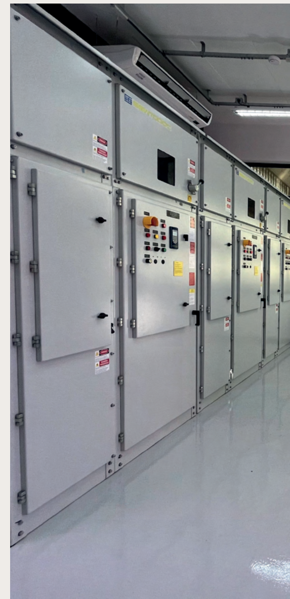
Novos painéis para a Estação de Recalque
